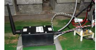
(d) Wireless control unit
